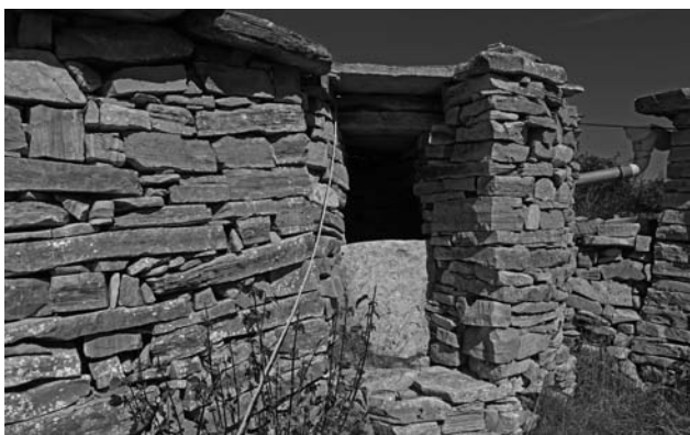
Zisterne mit Zufluss von der Dachrinne am Stall
